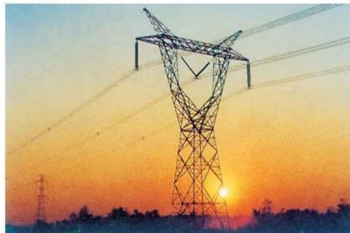
Hình 32.4. Đường dây truyền tải điện cao áp
